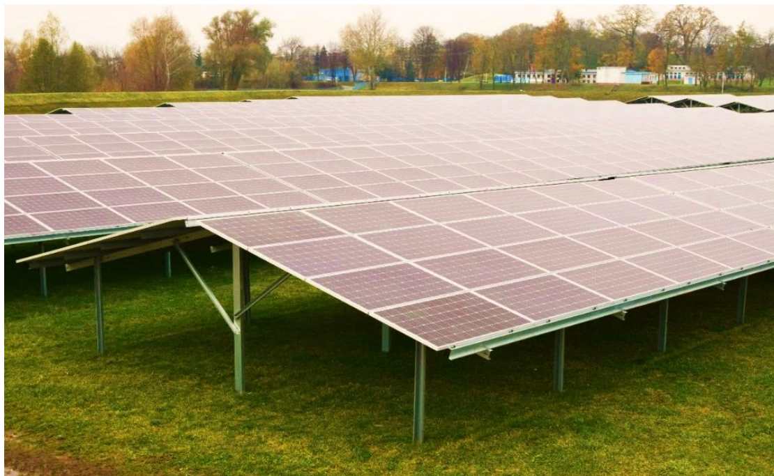
Fotografia 6. Instalacja fotowoltaiczna o mocy 1 MW, MPWiK Sp. z o.o. w Rzeszowie, ul. Zwiężczycka 46
